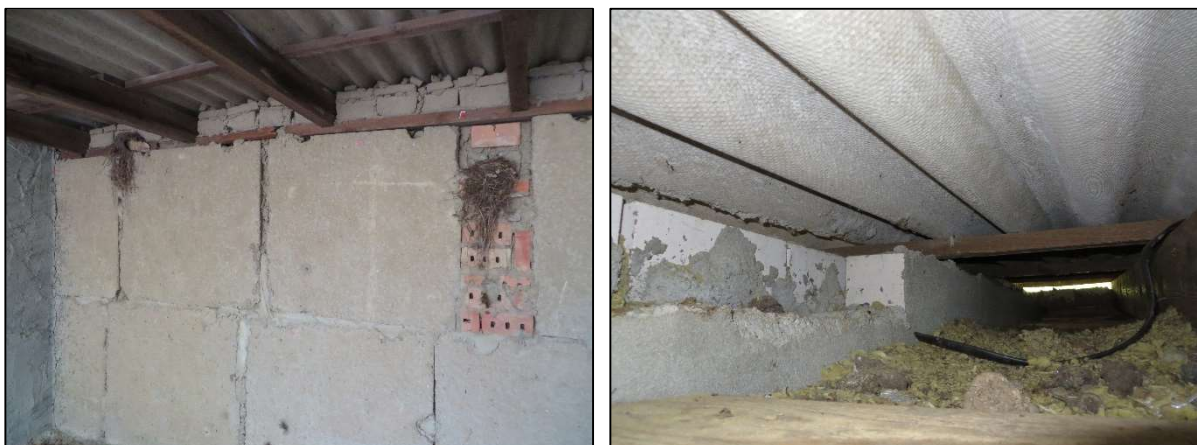
Abb. 16 & 17: Potentielle Fledermausquartiere an Gebäuden: Links Hohlräume in Hohlblocksteinen sowie Fugenspalten; Rechts Zwischenraum im frei zugänglichen Kaltdach (F. Sieg, 14.06.2018)
